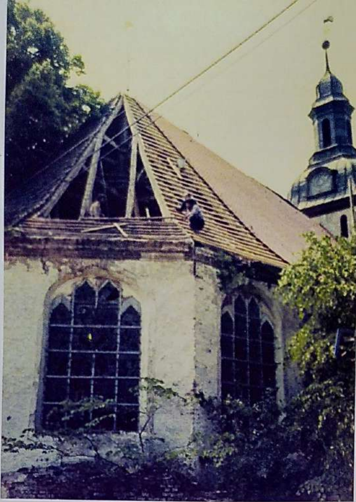
Abb. 3 Arbeiten am Traufgesims und an den Außenwänden der Nehringer Andreaskirche infolge der Schäden am Dach. Zustand bei Beginn der Neueindeckung 1986.
